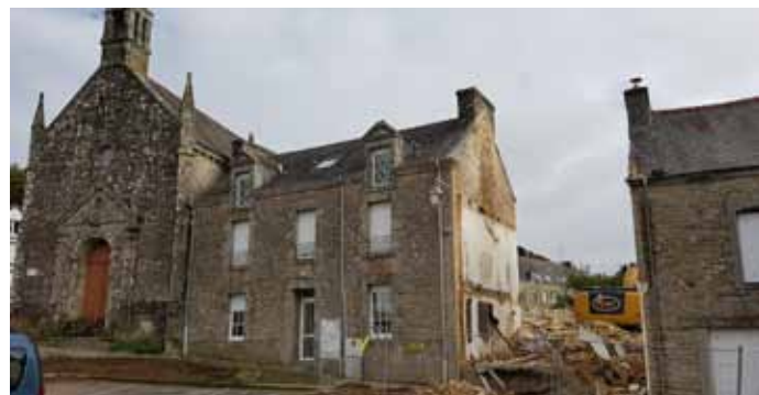
- Démolitions des maisons «Le Maréchal» et «Le Labourier» en prévision de la création de l'espace multi services avec l'emplacement du parking réservé à cet effet.
